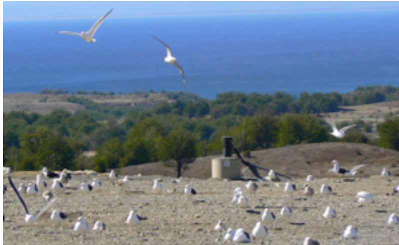
Puits de récupération de biogaz sur la décharge de Leña Dura en Patagonie Chilienne
